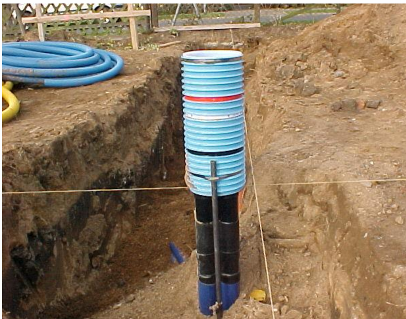
Die Fußbodeneinführung wird von der HEW HofEnergie+Wasser GmbH gesetzt, die dazu nötigen Erdarbeiten werden bis vor das Fundament von Ihnen ausgeführt.
