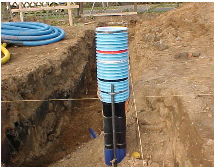
Die Fußbodeneinführung wird von der HEW HofEnergie+Wasser GmbH gesetzt, die dazu nötigen Erarbeiten werden bis vor das Fundament von Ihnen ausgeführt.
